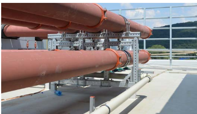
Obchodní centrum - Západní Slovensko, rozvody glykolu na streše
