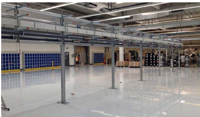
Kostal Zdice - Česká republika, uložení rozvodů
